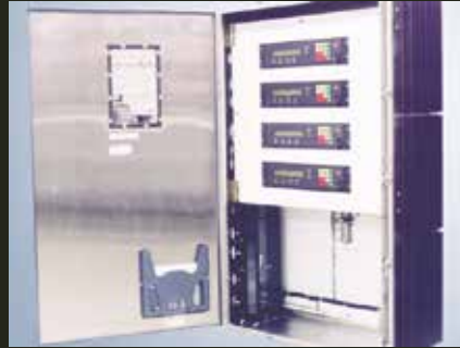
制御システム
